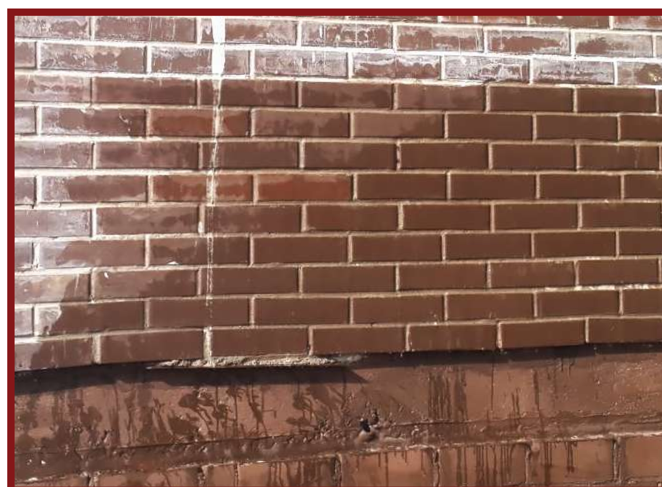
Фасад не защитили от дождя
