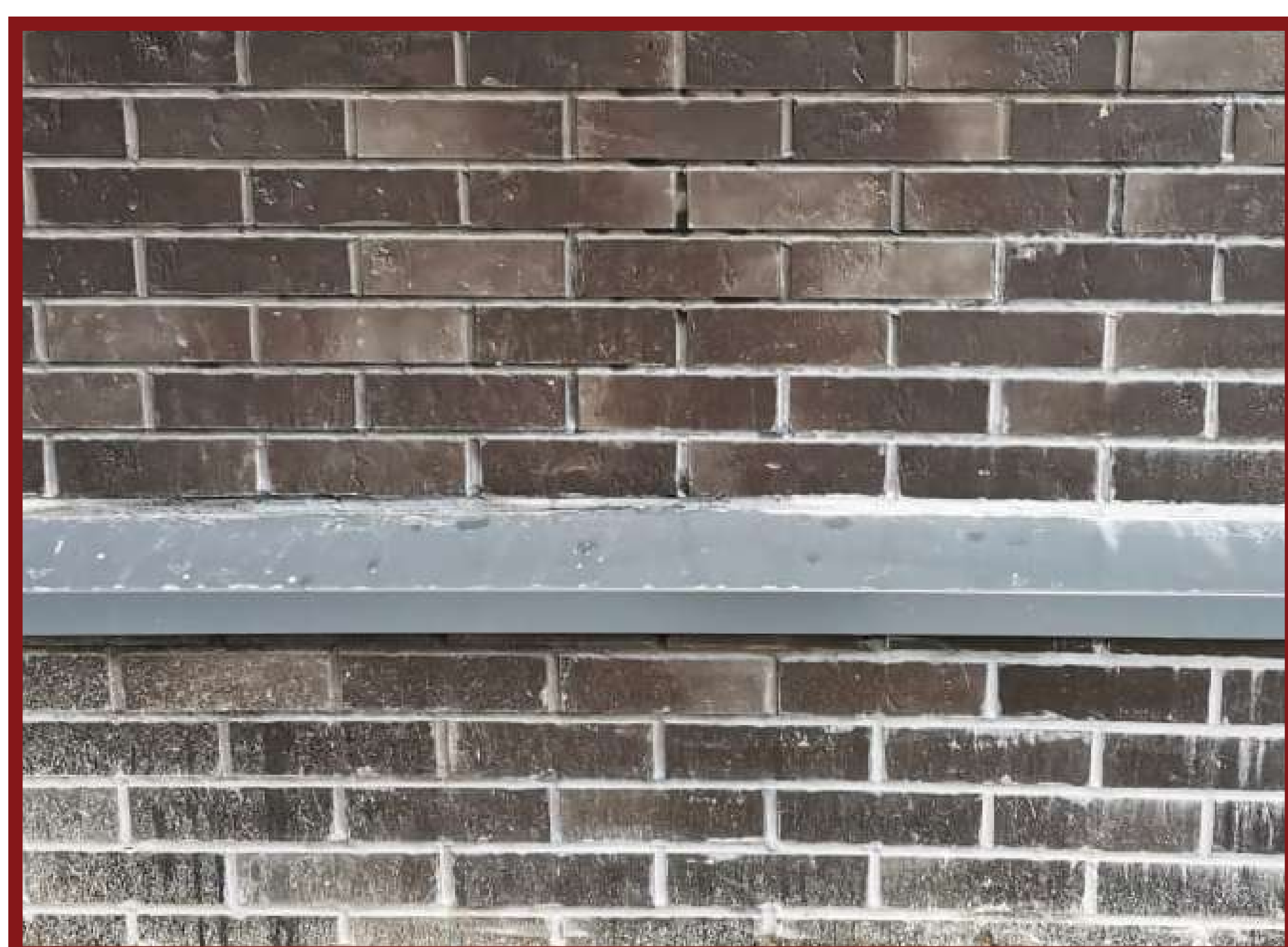
Фасад испачкан брызгами с лесов и земли
